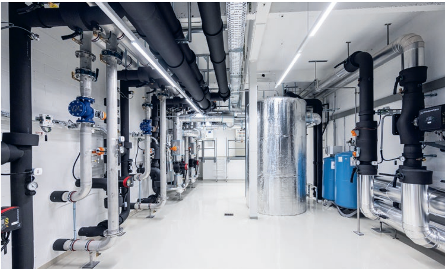
Die neue Kältezentrale der Wipf AG sorgt für eine präzise Regelung des Kältebedarfs.
